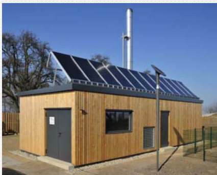
Impianto solare termico Superficie collettori 25 m 2
