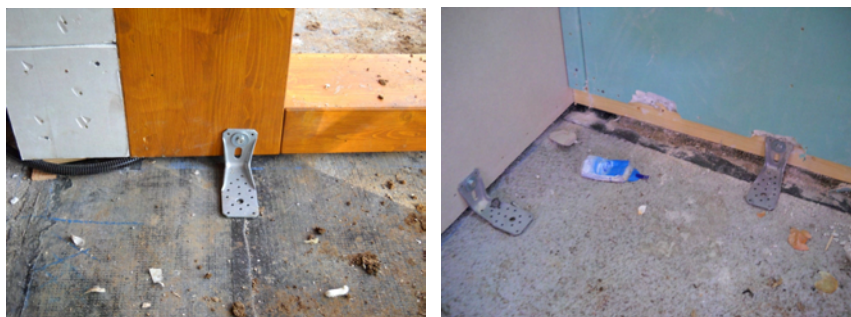
Errato posizionamento degli hold-down
