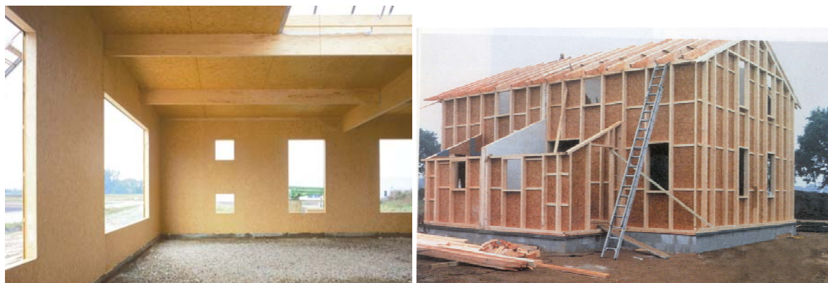
Figura 25: Capannone con costruzione leggera intelaiata – tamponamento interno in OSB (sin.) e OSB in edilizia abitativa – costruzione leggera intelaiata
