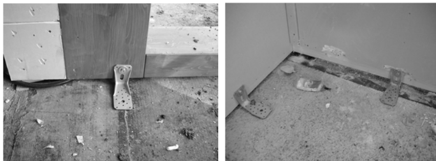
Errato posizionamento degli hold-down
