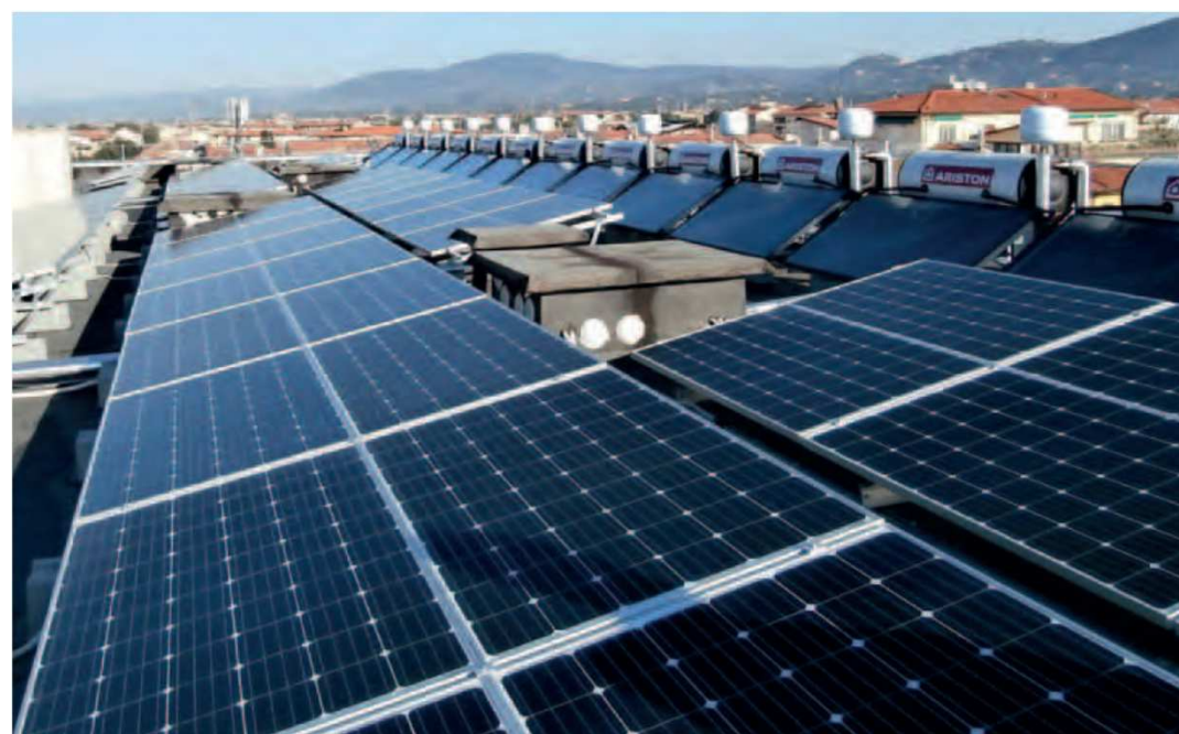
IMPIANTI SOLARI TERMICI E FOTOVOLTAICI A SERVIZIO DI OGNI VANO SCALA DELL'EDIFICIO A ED ALL'EDIFICIO B
