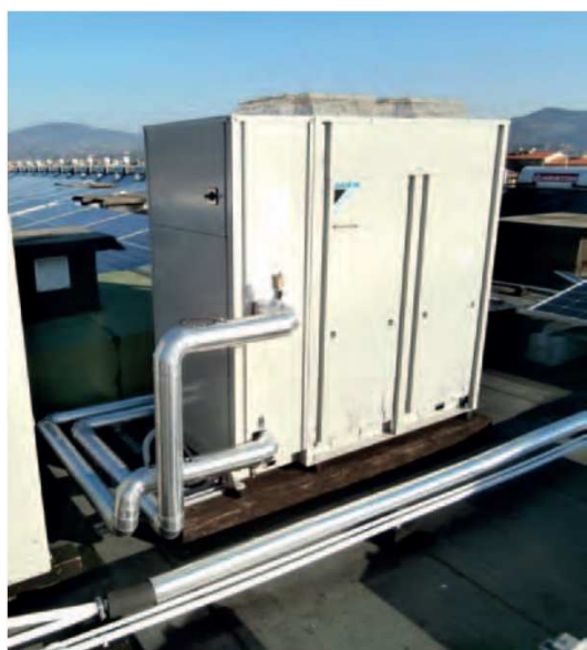
POMPE DI CALORE ARIA ACQUA A SERVIZIO DI OGNI VANO SCALA DELL'EDIFICIO A ED UNA DEDICATA ALL'EDIFICIO B
