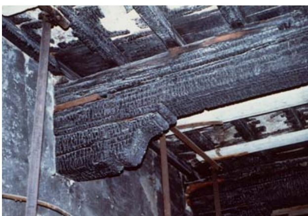
Figura 1: Solaio di legno non crollato a seguito di un incendio.
