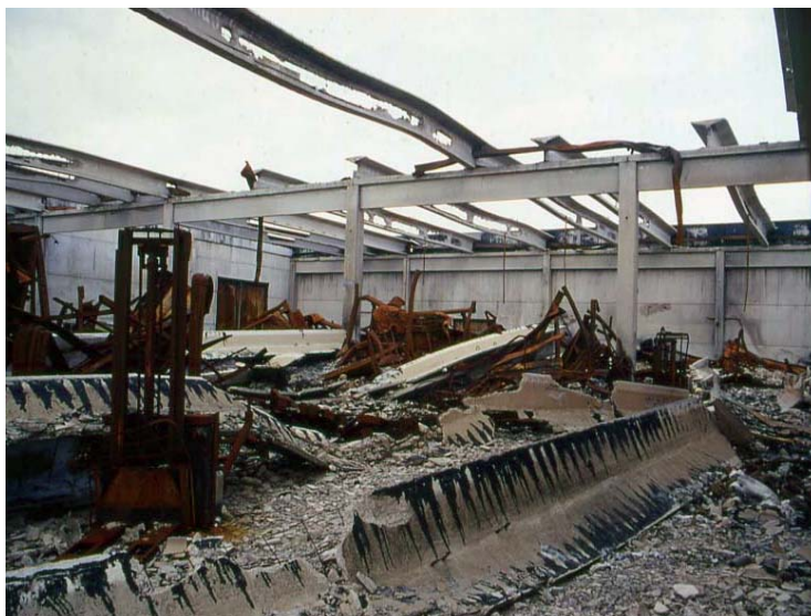
Figura 3: Capannone di cemento armato completamente distrutto a seguito di un incendio; le armature metalliche perdono resistenza e rigidità con l'aumento della temperatura, provocando rapidamente il crollo della struttura.
